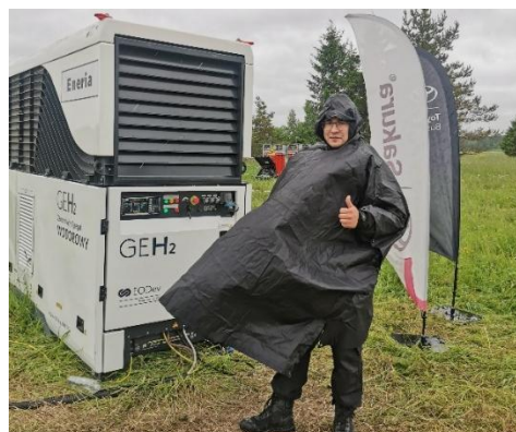
6. ábra: Az időjárás szeszélyes és változékony volt, de ez sem kedvünket, sem a villamosenergia minőségét nem befolyásolta
